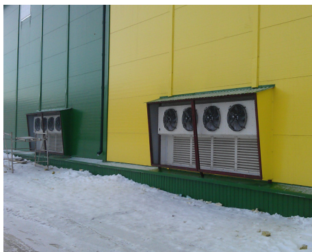
Gaugele Kompaktkühler im Einsatz
